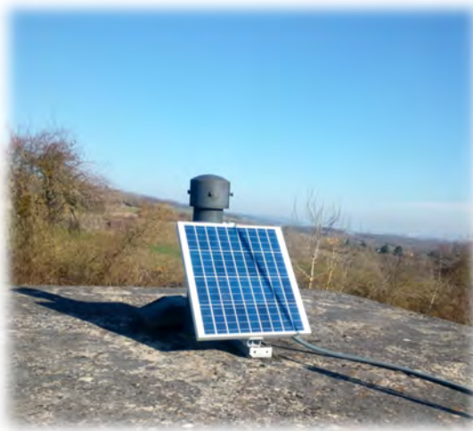
Panneau solaire de l'antenne télérelève
