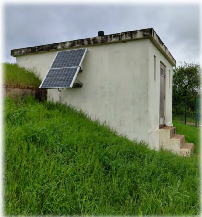
Panneau solaire du réservoir de Marieulles
