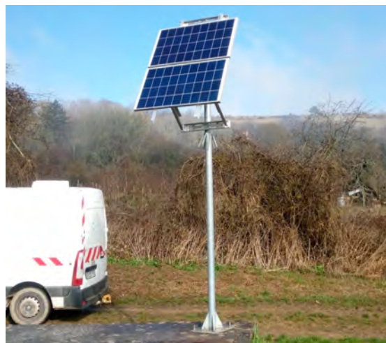
Panneau solaire du réservoir Lorry
