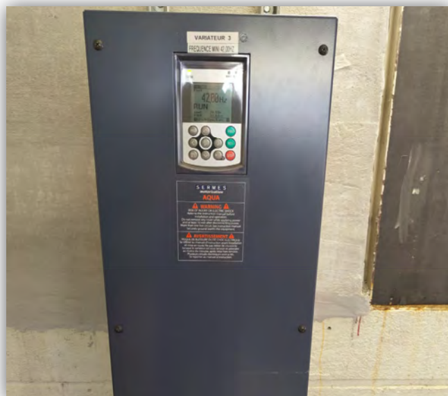
Variateur - Station de Châtel
