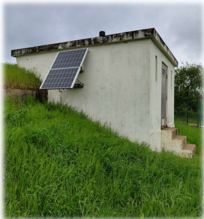
Panneau solaire du réservoir de Marieulles
