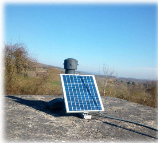
Panneau solaire de l'antenne télérelève
