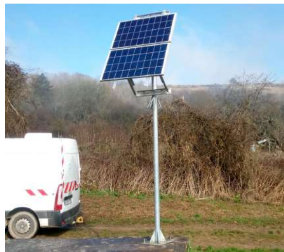
Panneau solaire du réservoir Lorry
