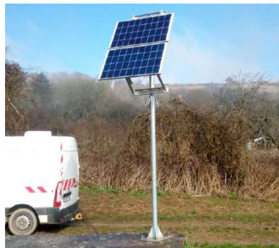
Panneau solaire du réservoir Lorry
