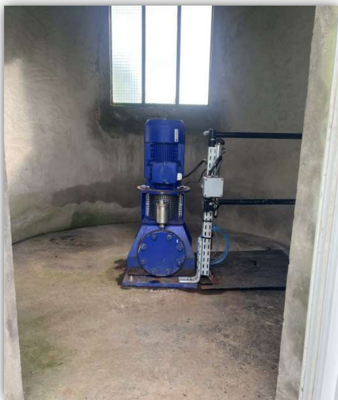
Pompe du puit 21 à Maison Rouge
