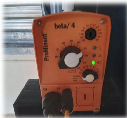
Pompe doseuse de chloration
