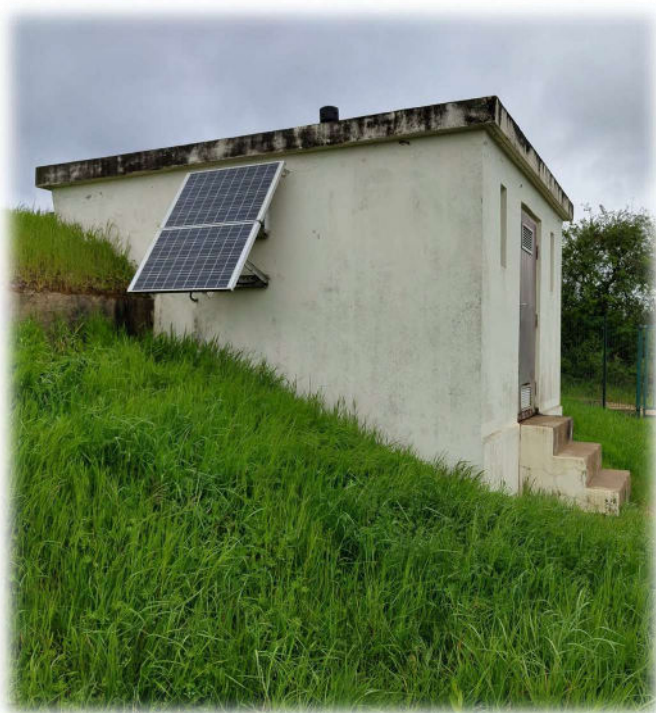
Panneau solaire du réservoir de Marieulles
