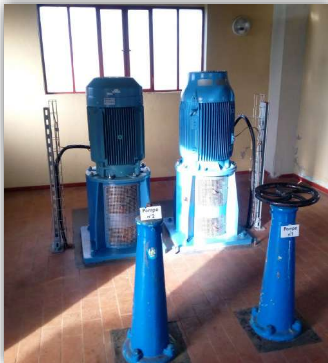
Pompe 1 - R3 à Maison Rouge
