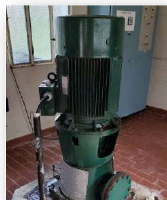
Pompe 3 à Châtel
